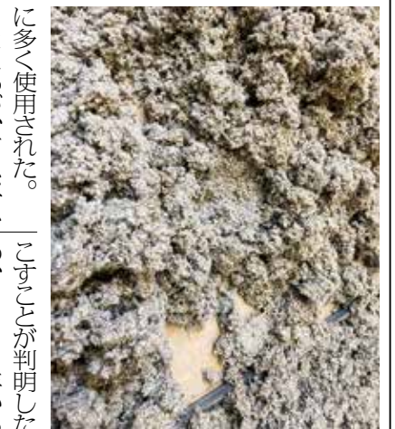
石綿(吹き付け)
